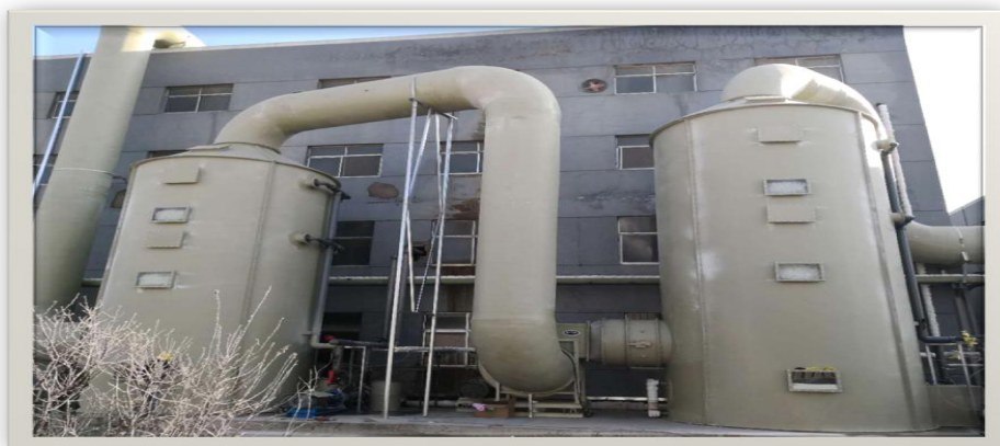
淀粉生产部一车间异味治理后设施
